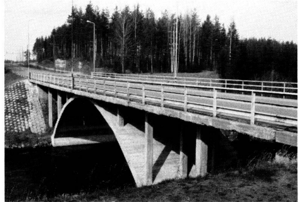
Fig. 1 The Käyräjoki bridge before repairing
