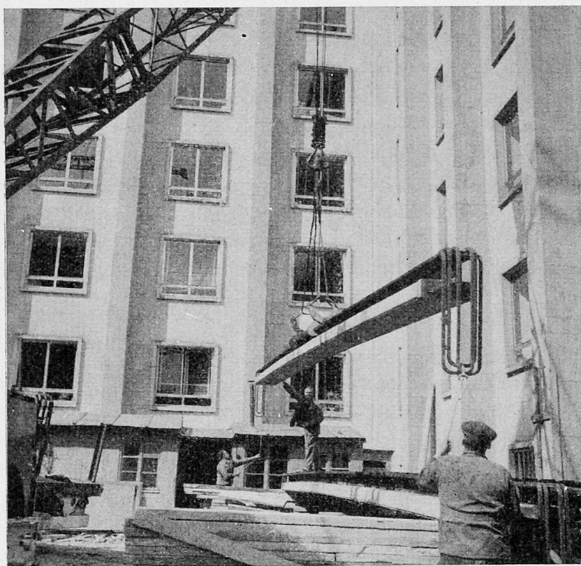
Fig. 4 - Complexe Administratif, rue de Louvain à Bruxelles . Poutres Preflex de 13,50 m avec aux extrémités des barres d'armature soudées à la poutrelle et servant à l'encastrement des poutres Préflex dans les colonnes.
