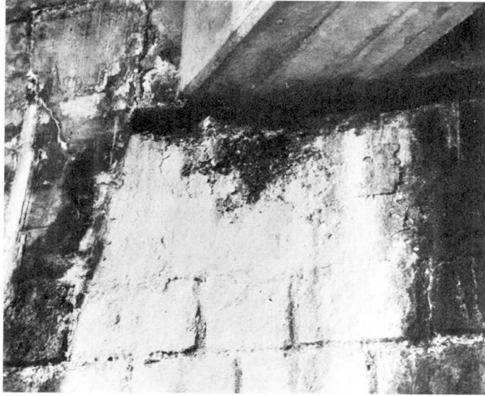
Fig. 1 Dégradations à l'infrastructure
