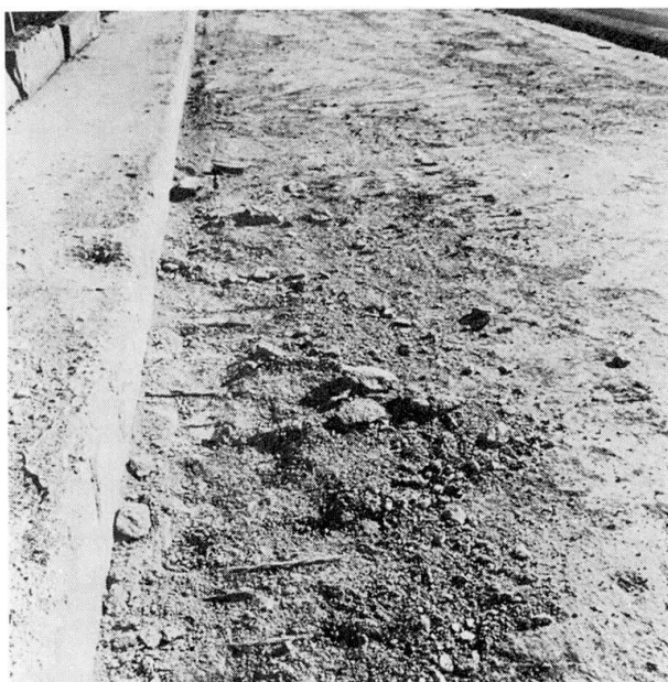
Fig. 4 Dégât de gel sous le revêtement
