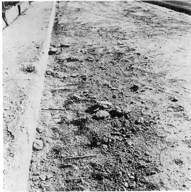
Fig. 4 Dégât de gel sous le revêtement
