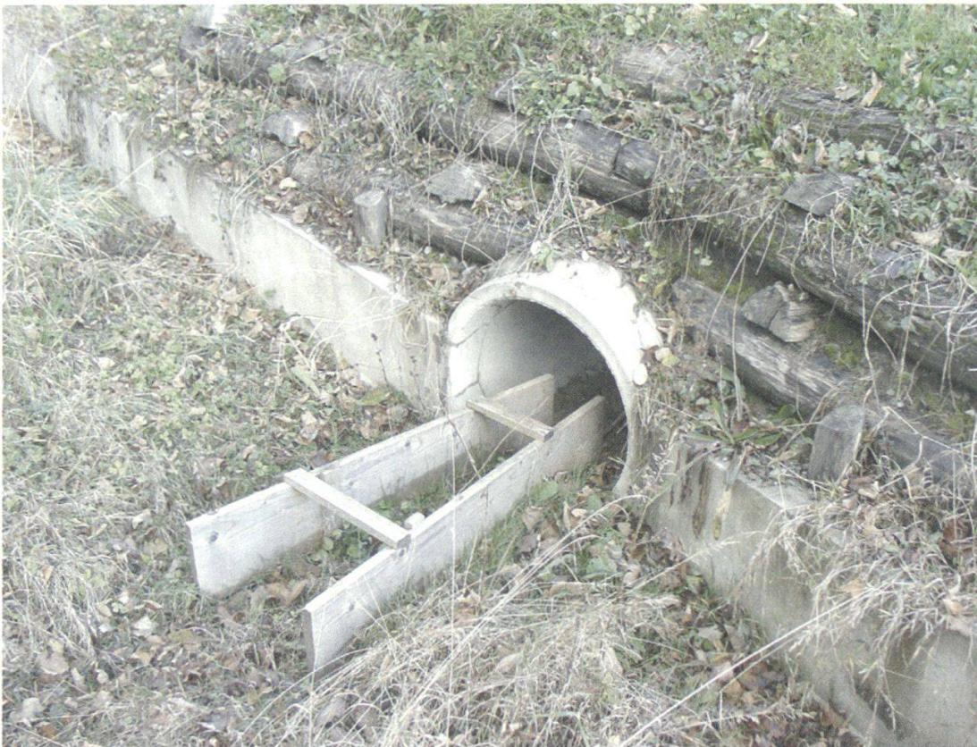
Figure 13.—Un déflecteur (ici en bois) mis en place à l'entrée de chaque passage (des deux côtés de la route) dès 2006 et permettant de maximiser le taux de pénétration des batraciens dans les passages inférieurs.
