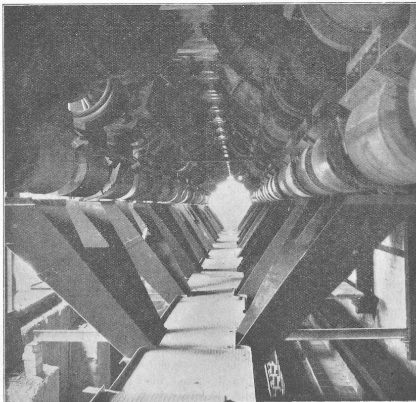
Fig. 54. — Fours. — Dessous des cornues avec gouttières de décharge.
