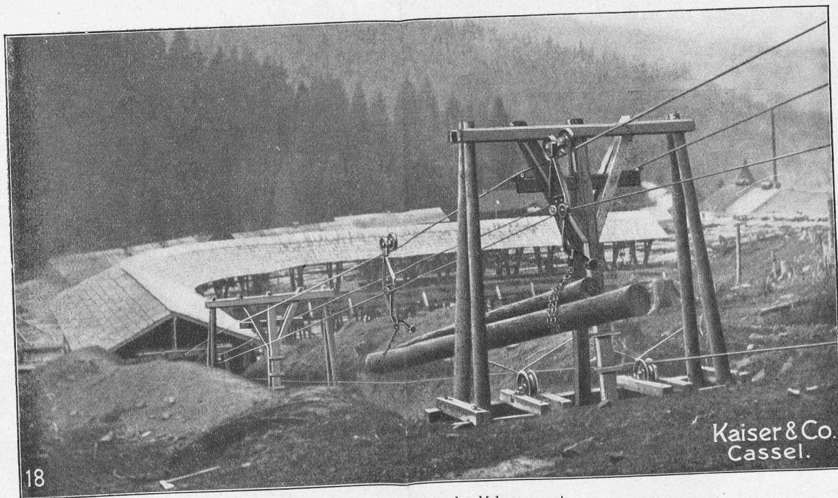
Entrée dans la station de déchargement
