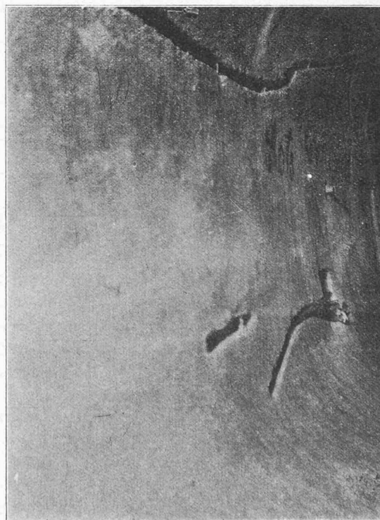
Fig. 6. — Fissures dans le piédroit à l'hectomètre 7,43. Photographie prise par M. Büchi, le 21 juillet 1920.
