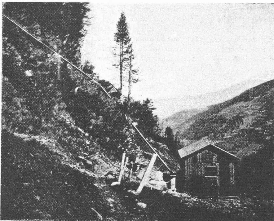
Fig. 1. — Conduite forcée en tubes de fer électrolytique Bévé . Hauteur: 100 m. — Diamètre: 20 cm. — Épaisseur: 2 mm.
