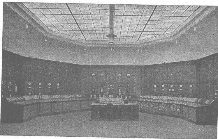
Salle de commande à l'usine électrique d'Amsteg. (Electrification des Chemins de Fer Fédéraux).
