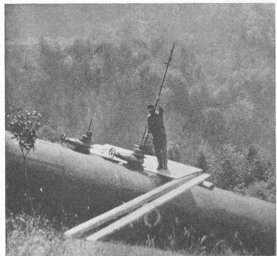
Fig. 3. — Station de jaugeage sur deux conduites forcées parallèles de 1801 mm. de diamètre intérieur.
