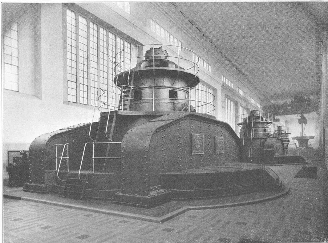
Fig. 14. — Vue de la salle des machines de l'usine de Kembs et de l'un des alternateurs.
