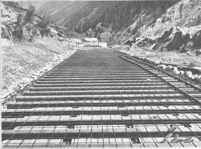
Fig. 3. — Km. 34,5, à Lugelwand, près de Zermatt. Construction du plafond du tunnel artificiel.
