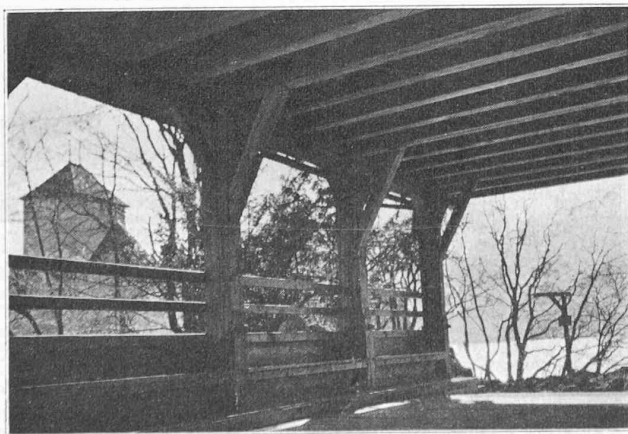
Fig. 6. — Le nouveau couvert en bois du château de Chillon, vue de dessous.
