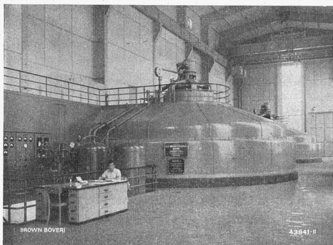
Forces Motrices de l'Aar S. A., Centrale de Klingnau. Vue partielle de deux des trois alternateurs triphasés de 19500 kVA, 10500 V. 75 t/min, 50 p/s.
