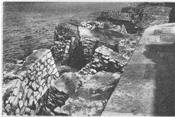
Fig. 10. — Blocs du large, de la jetée de Marseille, désagrégés, à la suite de l'attaque du mortier par l'eau de mer.
