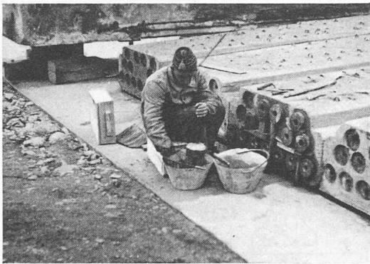
Fig. 4. — Pont de Fribourg. Cônes d'ancrage femelles scellés dans niches ménagées à l'extrémité des poutres.
