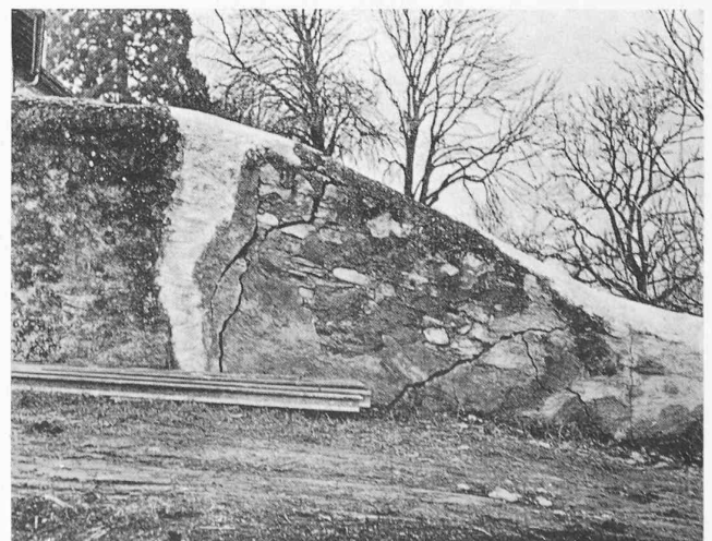
Fig. 7. — Chancy. Mur déformé par les glissements de terrain, rive suisse.
