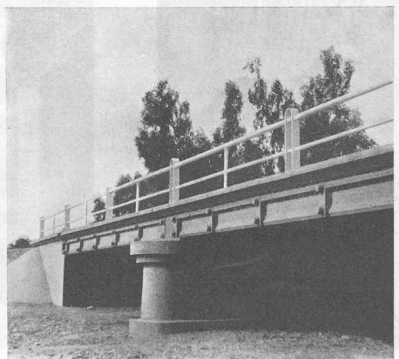
Fig. 20. — Pont sur l'Oued Saad en Tunisie, comprenant deux travées constituées par des poutres de 10 m jointives.
