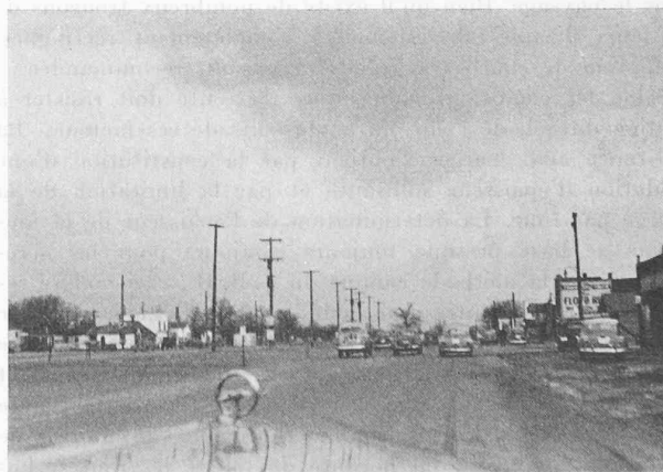
Fig. 13. — DÉTROIT, Michigan . Route Mich. 102 à Ferndale. Un des deux tronçons de routes chauffées pour le déblayage des neiges. On distingue les poteaux et les transformateurs d'amenée du courant.
