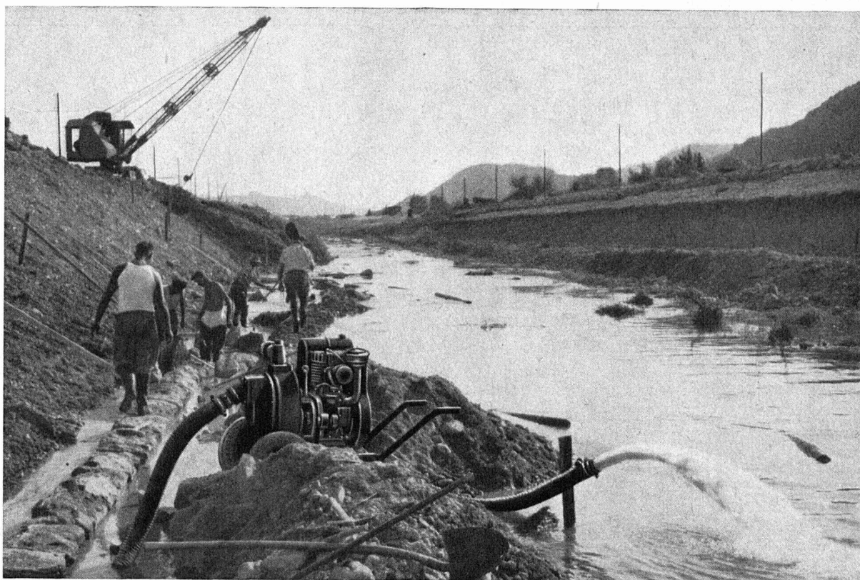
Pompe centrifuge auto-aspirante MARLOW en action.
