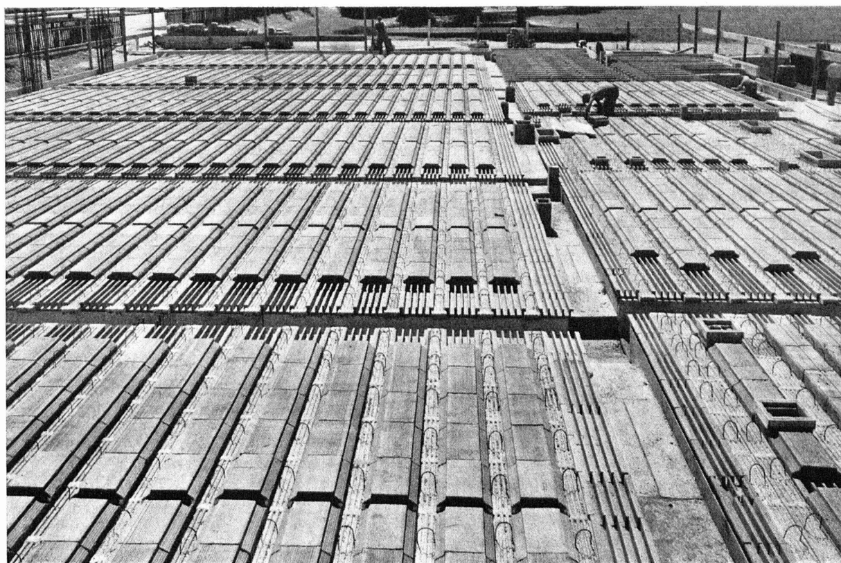
Exécution du plancher d'une salle de gymnastique en dalles STAHLTON — STHALTON-WERK BERN A. G., Berne-Lieberfeld Photographie Alfred Löhndorf, Bâle
