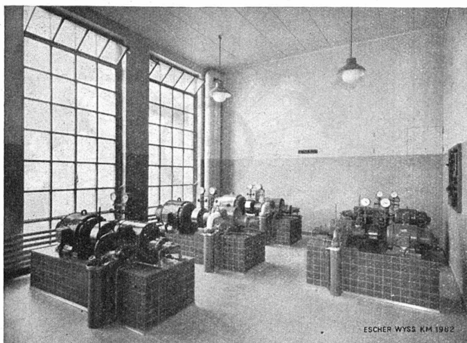
Salle des machines avec 5 compresseurs «ROTASCO» pour la réfrigération et les entrepôts frigorifiques
