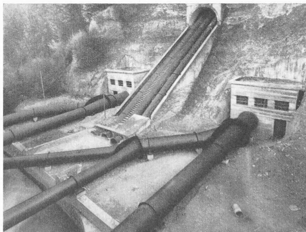
Fig. 20. — Conduites forcées. Au centre : conduites désaffectées de l'ancienne usine.
