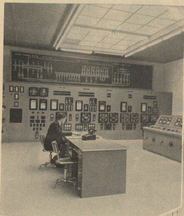
Poste de commande et salle des machines de la centrale de Rossens-Hauterive.
