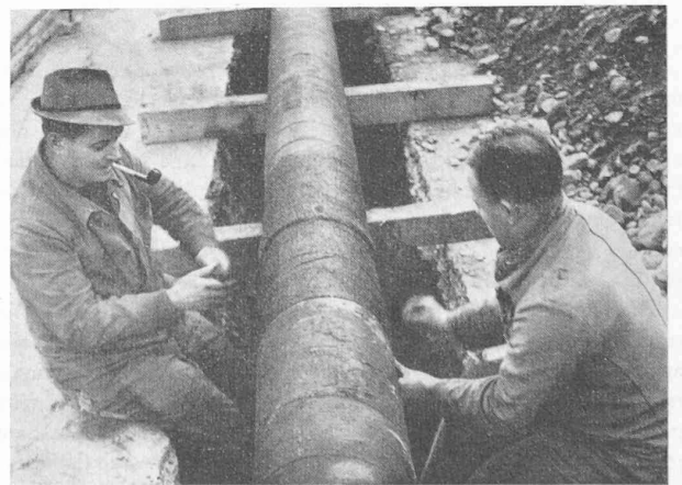
Fig. 3. — Isolation d'un joint soudé d'une conduite à gaz de la Ville de Zurich.
