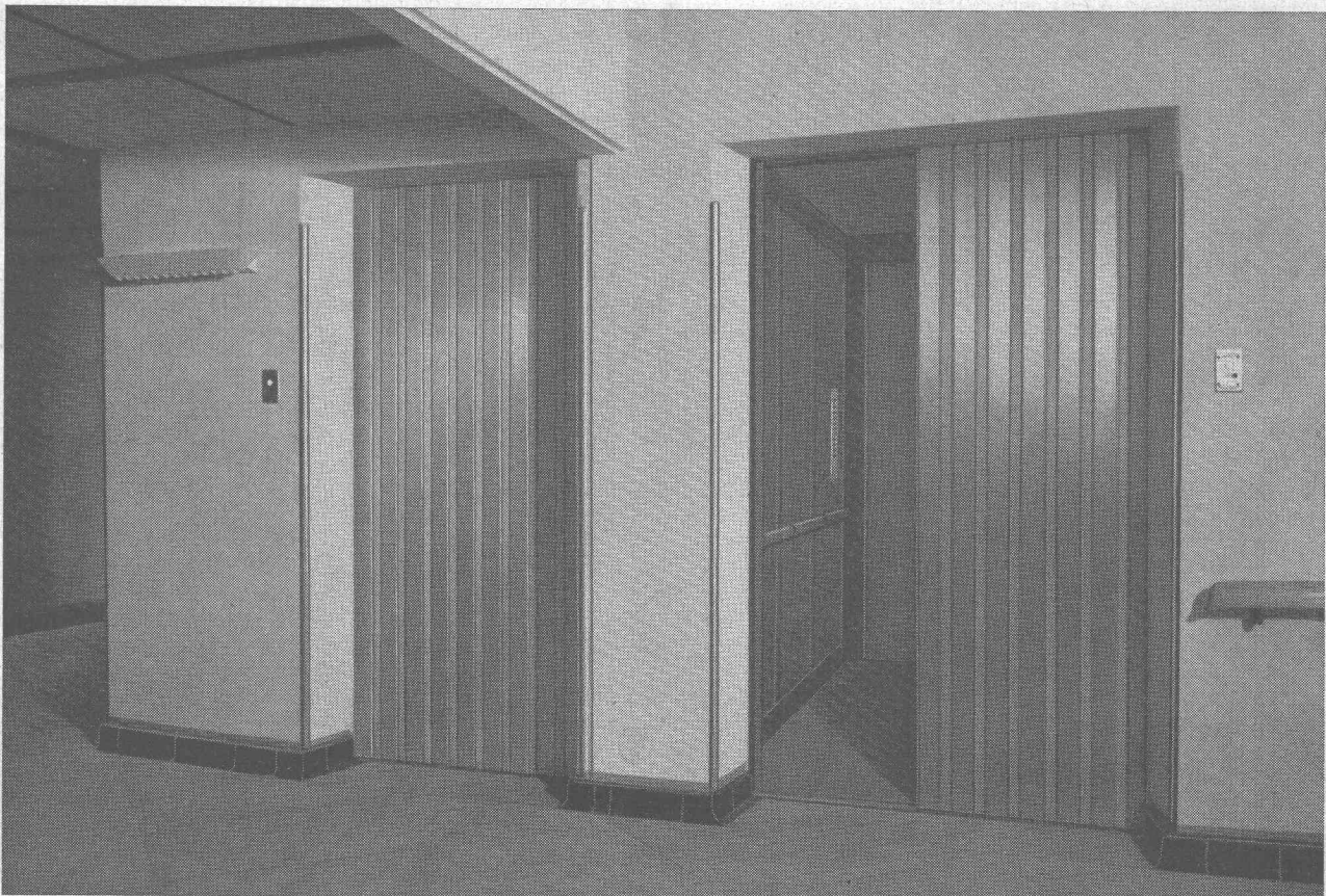
Portes automatiques d'ascenseur Schlieren « Portaflex » installées dans un hôpital.
