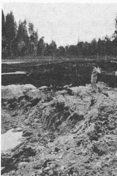
Fig. 23. — Glissement dans les berges de la tourbe durant l'excavation.
