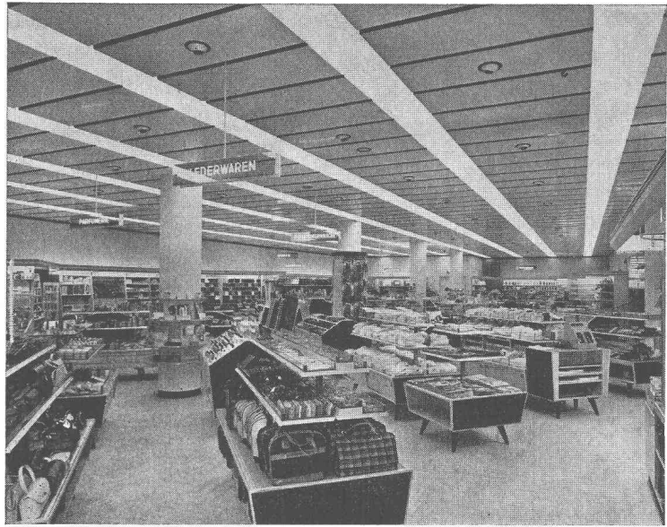
Grands Magasins « Innovation » à Brigue Distribution d'air climatisé par le plafond
