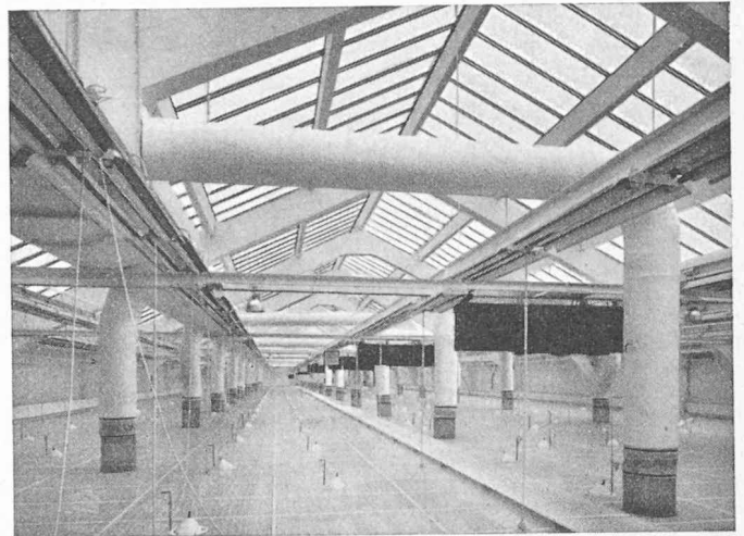
Fig. 13. — Le vide de toiture, avec le réseau de distribution des gaines d'air climatisé ; les raccords sont en matière transparente. En haut, à gauche, vue partielle d'un gros amortisseur de bruit.
