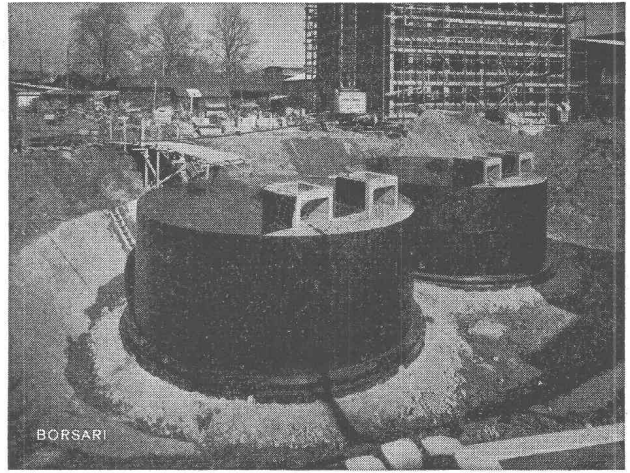
Verkehrsbetriebe der Stadt Luzern, 2 Tanks, 300'000 Liter Dieselöl.
