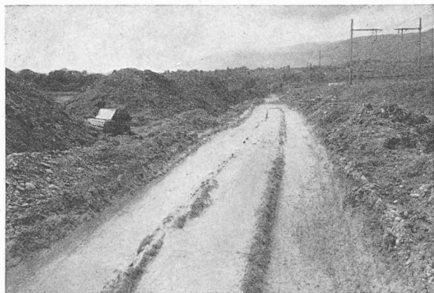
Fig. 9. — Voie d'accès transformée en fondrière.
