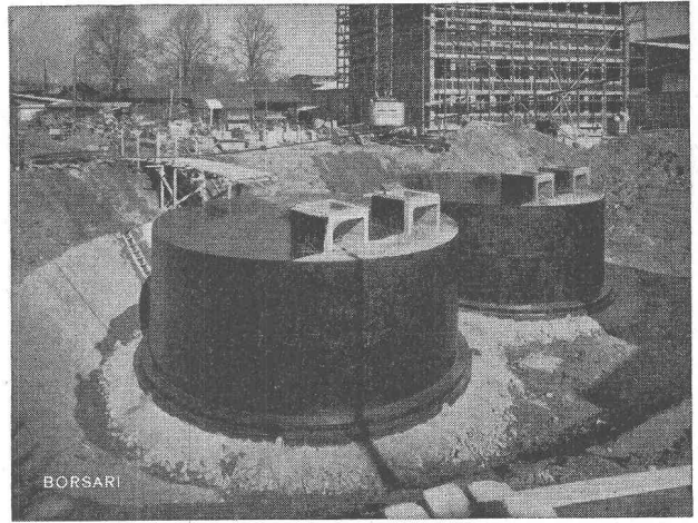
Verkehrsbetriebe der Stadt Luzern, 2 Tanks, 300'000 Liter Dieselöl.
