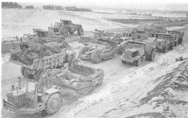
Fig. 3. — Une partie du parc de machines affectées aux gros terrassements ; la tranche de travaux la plus mécanisée.
