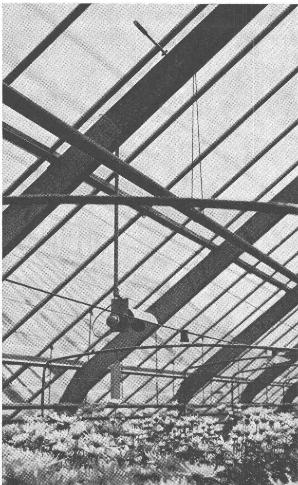
Serre avec contrôle de la température en fonction de la lumière du jour.
