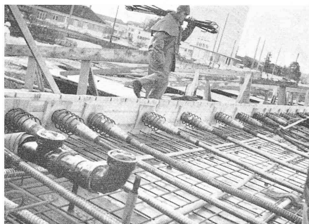
Fig. 2. — Têtes des câbles de l'entrepôt avant la pose de l'armature morte supérieure et le frettage des têtes.
