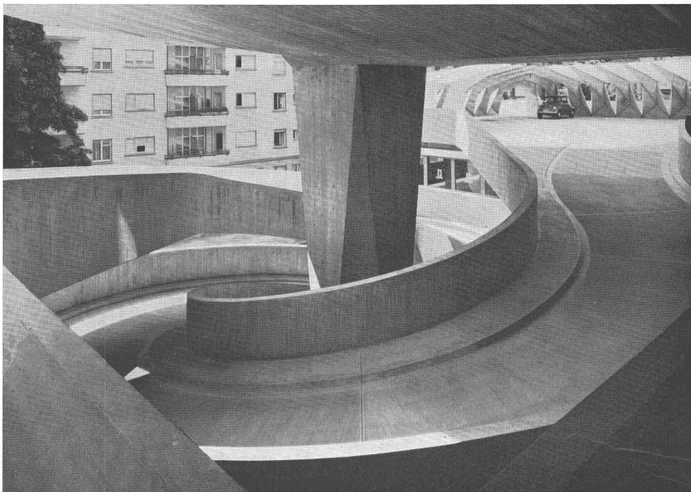
Rampe d'accès de la maison-tour « zur Palme » à Zurich. Chape en béton dur Korodur, exécutée par l'entreprise Hein. Hatt-Haller S. A. à Zurich.
