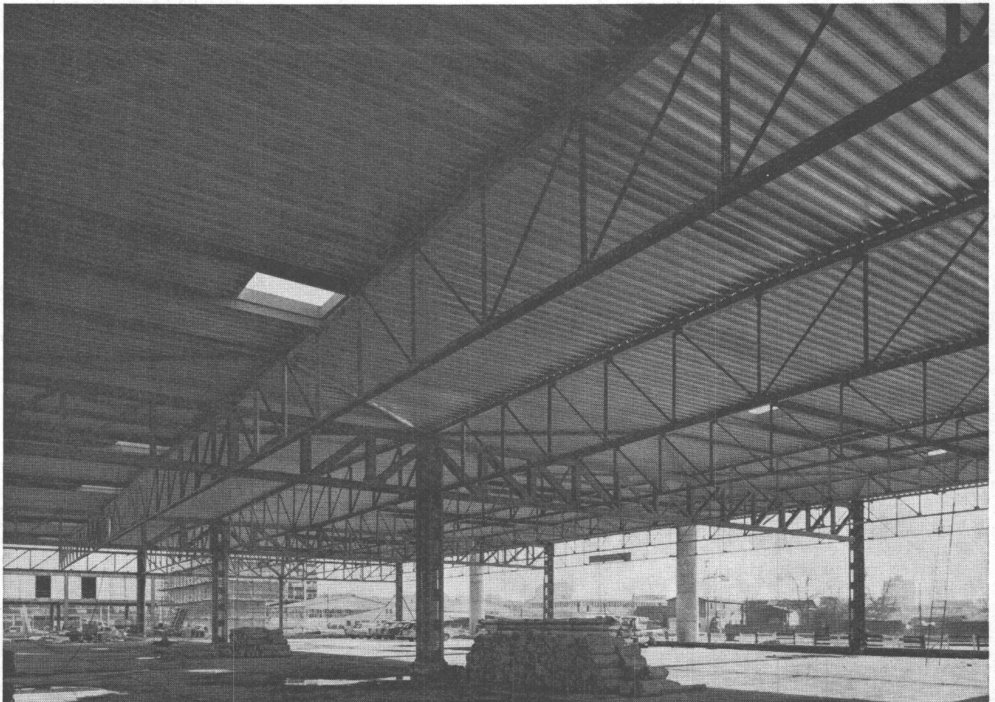
Centre de la voirie des Vernets, Genève. Charpente métallique du hangar, en cours de montage. Architectes : J.-P. Dom, F. Maurice et L. Parmelin. Exécution : Zwahlen & Mayr S. A., Lausanne/Aigle, en collaboration avec une autre entreprise romande.
