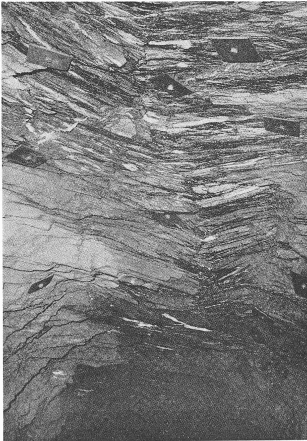
Fig. 24. — Fissure de traction au toit d'une galerie profonde.
