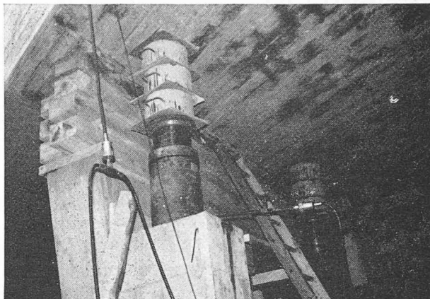
Fig. 3. — Vérinage du pont-rail reposant encore sur les cales en bois au sommet des piles intermédiaires. Les vérins de 250 t s'appuient sur des piles provisoires en béton.
