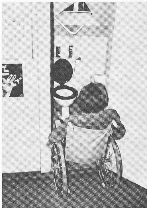
Fig. 3. — Portes de toilettes larges de 65 cm seulement, constituant un obstacle absolument impossible à franchir.
