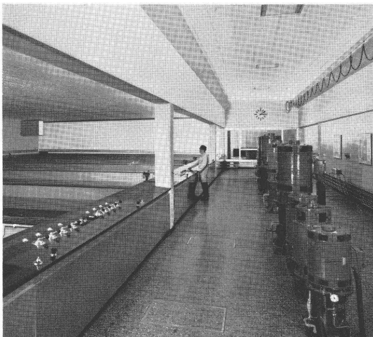
Installation de filtres rapides de Champ-Bougin, appartenant à la ville de Neuchâtel, pour le traitement d'eau du lac en eau potable. Capacité 1800 m 3 /h.
