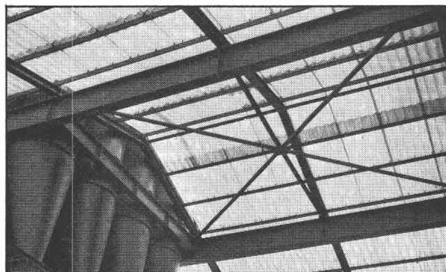
Toit vitré de neomat pour un silo
