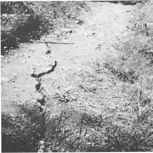
Fig. 16. — Fissure le long d'un chemin de berge ouverte lors de la vidange de 1972.
