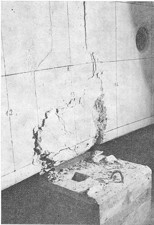
Fig. 10. — Ecrasement de la zone comprimée sur appui.
