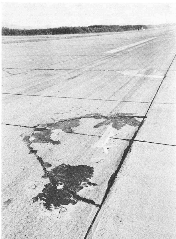
Fig. 1. — Des dizaines de dalles sont dans ce triste état. On distingue le clouage des éléments disloqués.
