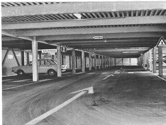
Vue intérieure du PARKING POUR LE GRAND MAGASIN NORMANN AG à Olten
