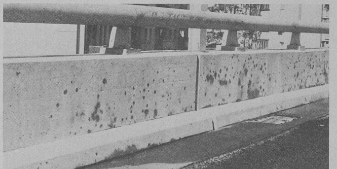
Après le nettoyage au jet d'eau et de sable, la surface nettoyée du parapet en béton sèche lentement. Les endroits sombres indiquent soit de grosses porosités, soit du béton présentant une forte capacité d'absorption. (Photo Meynadier.)
