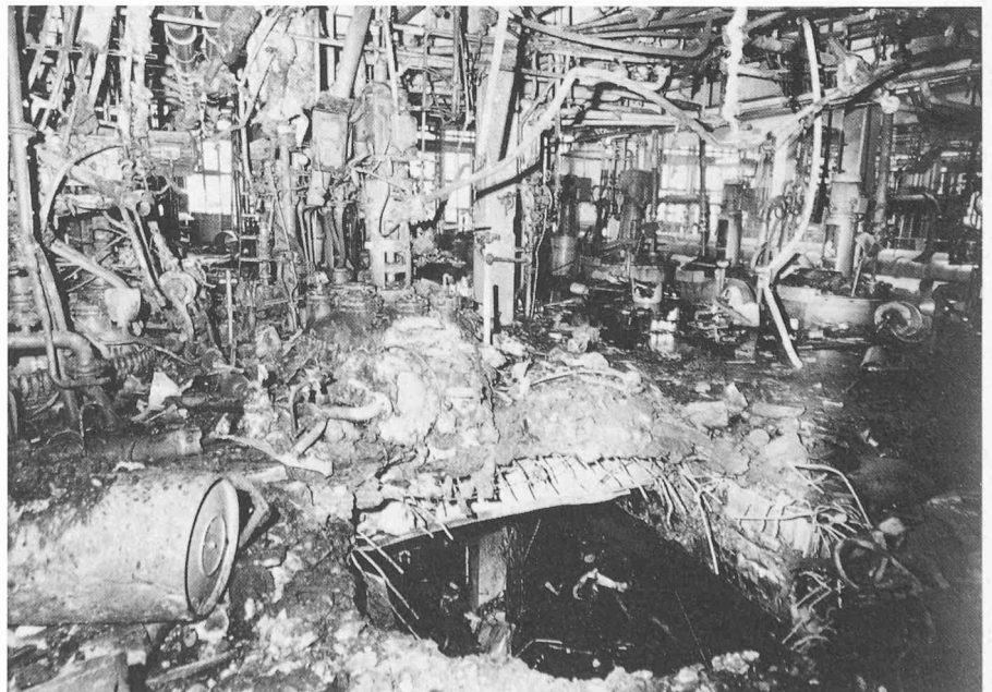
Fig. 1. — Explosion dans une fabrique de produits chimiques. Même la dalle de béton armé a cédé sous la violence de l'explosion.
