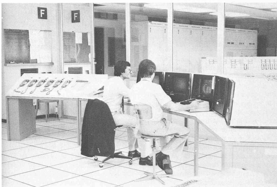
Fig. 2. — 3000 points distincts de surveillance et de commande sont reliés au centre de contrôle.
